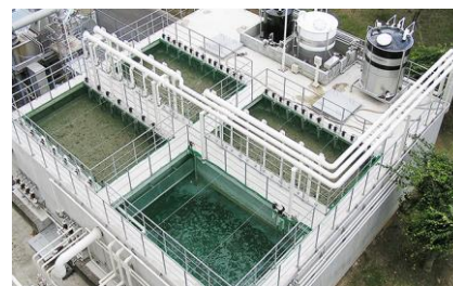
水処理システム
